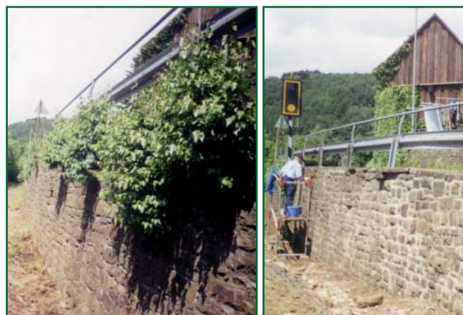
Zersetzend: Bewuchs an einer Stützmauer. Nach der Entfernung wurde die Mauer neu verfugt (Bielstein, 1999, Fotos Slg. Natalie Hergert).
