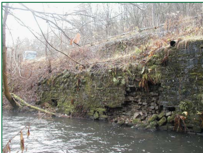
Jahrzentelang vernachlässigte Stützmauer am Wiehler Freizeitpark ... (Wiehl, 24. November 2003, Foto Gerhard Mansel).
