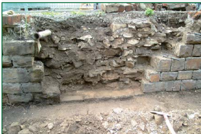
Zustand vor der Sanierung (Fotos Christof Weschenbach, Klaus Schade)
