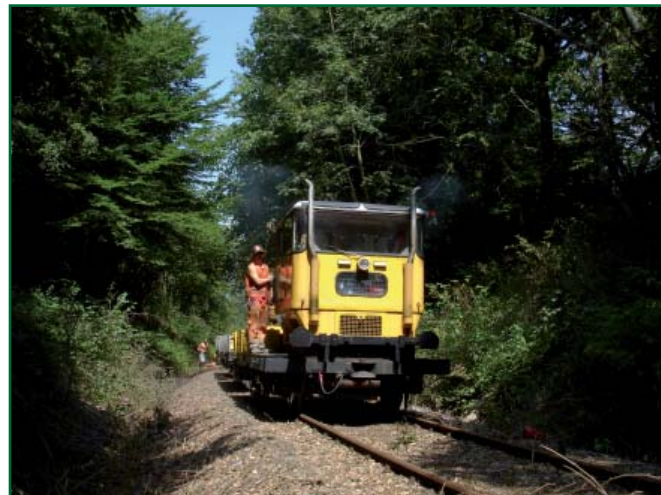
Die durchgehende Befahrbarkeit vereinfacht Sanierung und Instandhaltung ungemein, sei es mit den eigenen Arbeitsfahrzeugen (oben: 21. Juli 2006, Foto Ulrich Clees) oder mit Fahrzeugen von Fachfirmen, etwa Turmtriebwagen zur Brückenunterhaltung oder Zweibege-LKWs und -Unimogs zur Vegetationskontrolle.
